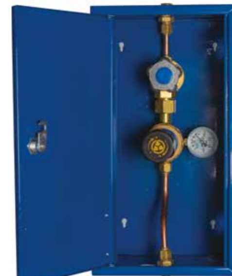
Пост газорозбірний кисню ПГК-10-3 М ДМ 842.000.72
